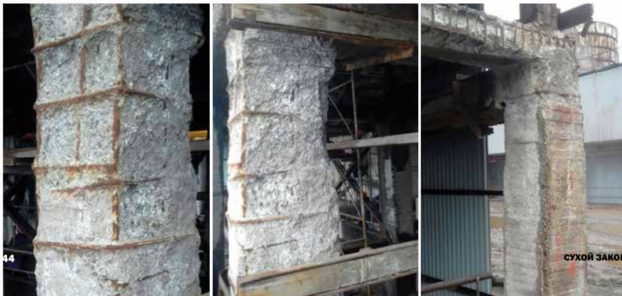
Разрушенная «колоннада» над чашей градирни
